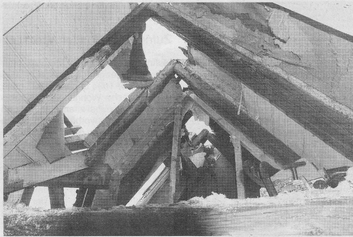
Der Dachstuhl des Wohnhauses im Domherrngässchen ist völlig ausgebrannt.
