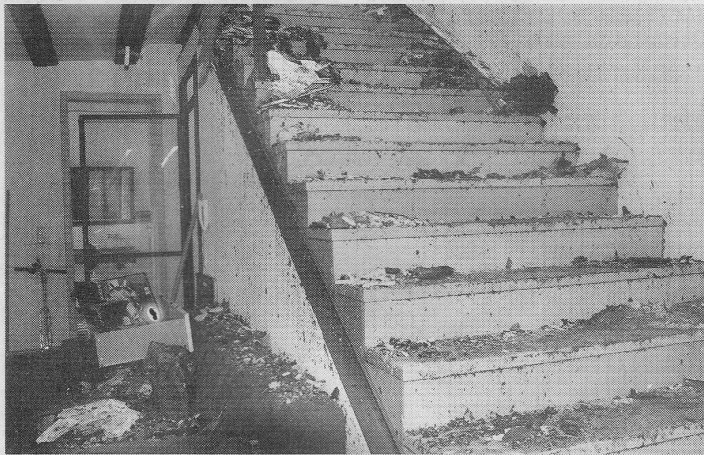
Der Innenbereich des Wohnhauses im Domherrngässchen wurde durch den Brand und das Löschwasser stark in Leidenschaft gezogen.
